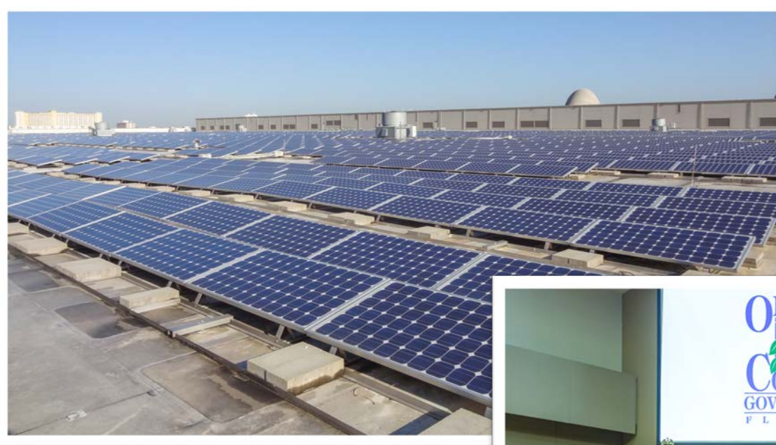
OCCC 2 MW Solar Array
